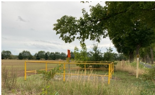
Abbildung 14: Vorhandene Infrastruktur der EWE Netz GmbH (im nordwestlichen Bereich des Plangebiets Agri-PV-Anlage an die K6005 angrenzend) mit Leitungstrassen in Richtung TG1 und TG2
